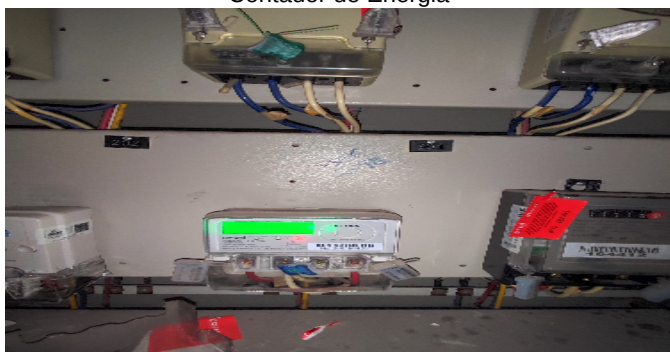
Contador de Energia
