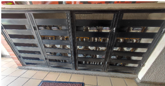
Contador de Gas
