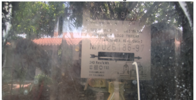
Contador de Energia
