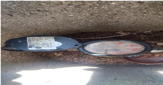
Contador de Agua
