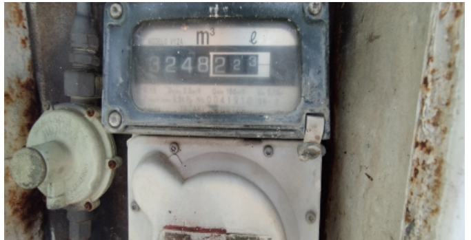
Contador de Gas
