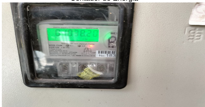
Contador de Energia
