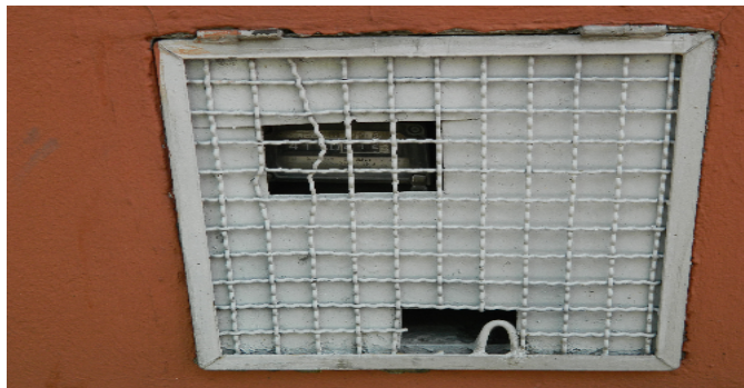
Contador de Gas
