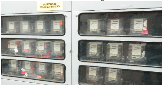
Contador de Energia
