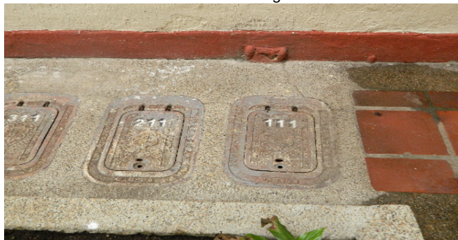
Contador de Agua
