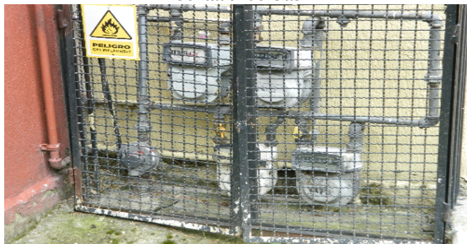
Contador de Gas
