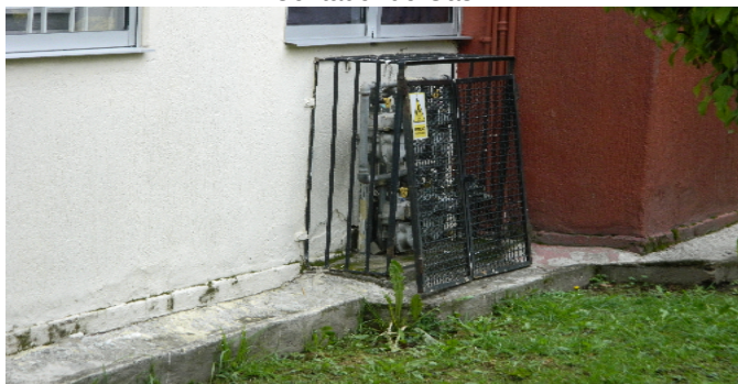
Contador de Gas
