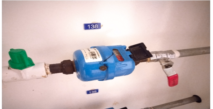
Contador de Agua
