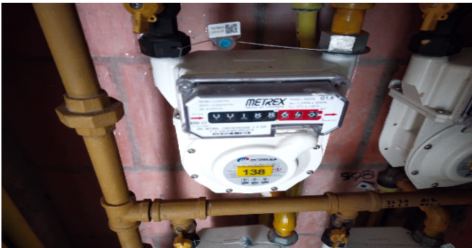
Contador de Gas
