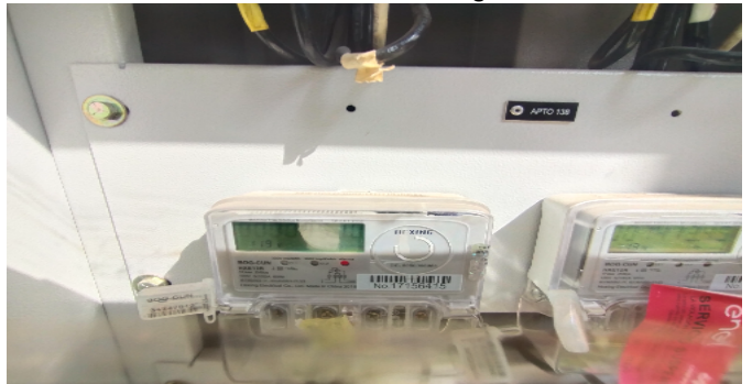
Contador de Energia
