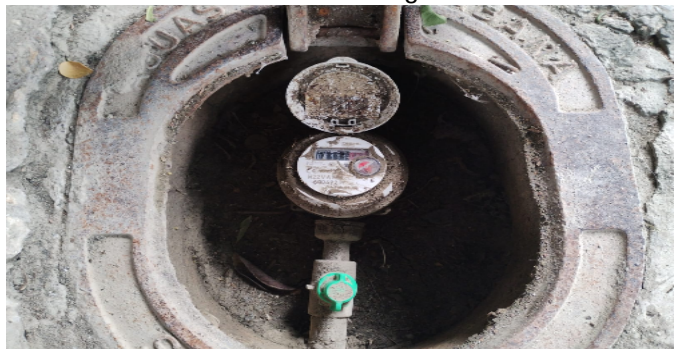
Contador de Agua
