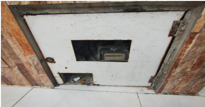
Contador de Gas
