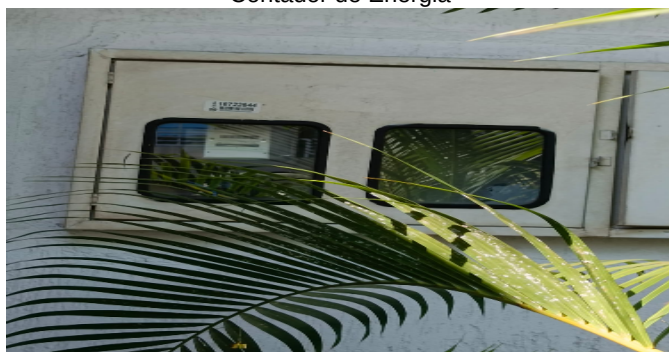
Contador de Energia
