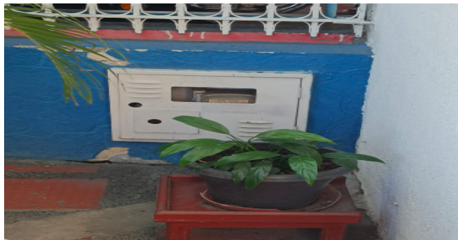
Contador de Gas
