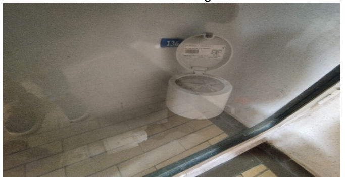
Contador de Agua
