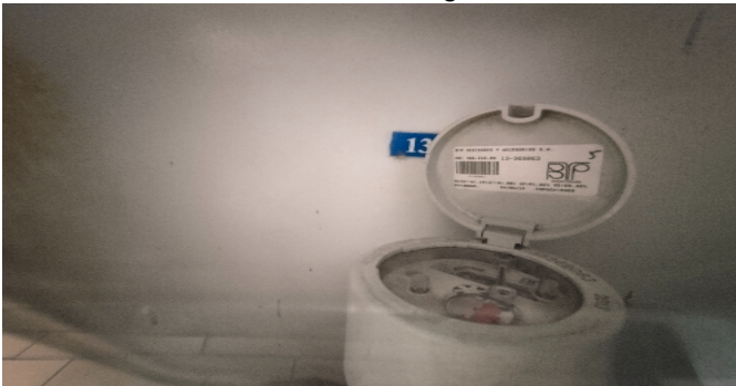
Contador de Agua
