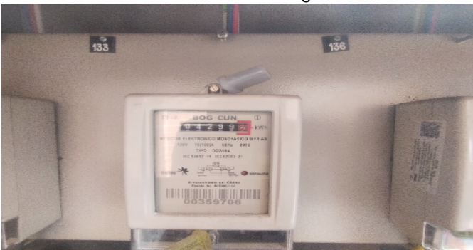
Contador de Energia
