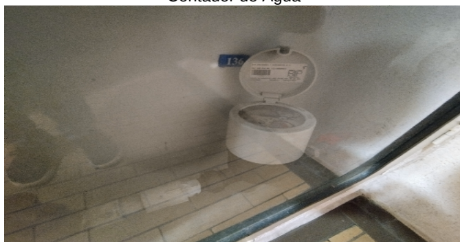
Contador de Agua
