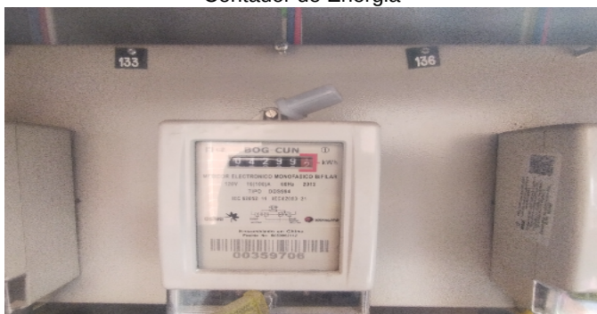
Contador de Energia
