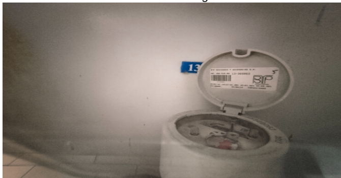
Contador de Agua
