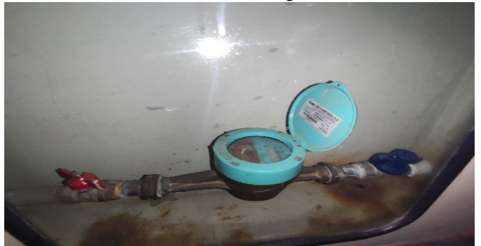
Contador de Agua
