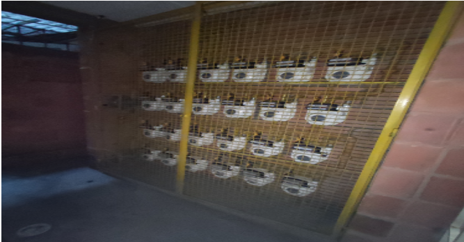
Contador de Gas
