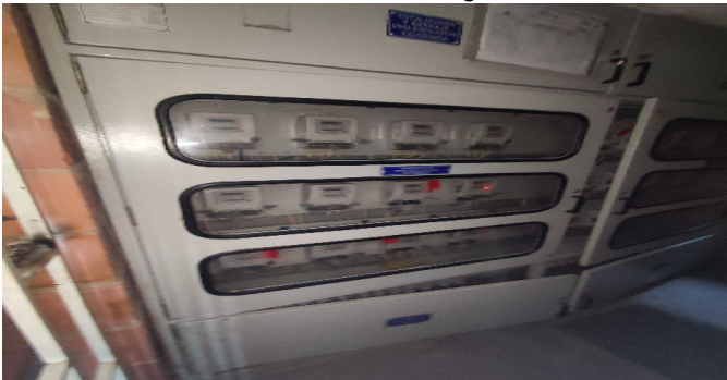
Contador de Energia
