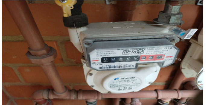
Contador de Gas
