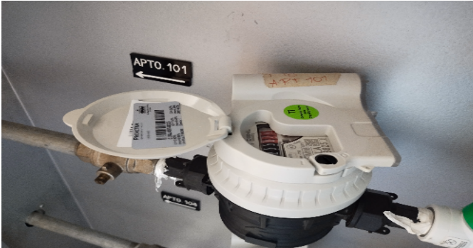
Contador de Agua
