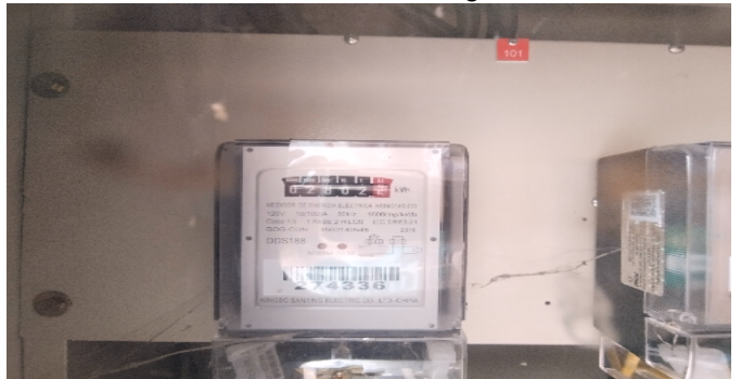
Contador de Energia
