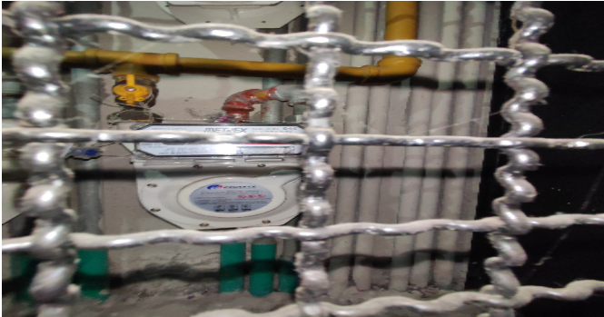
Contador de Gas
