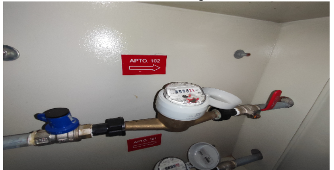
Contador de Agua
