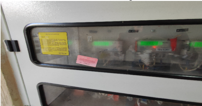
Contador de Energia
