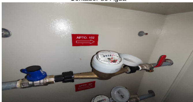
Contador de Agua
