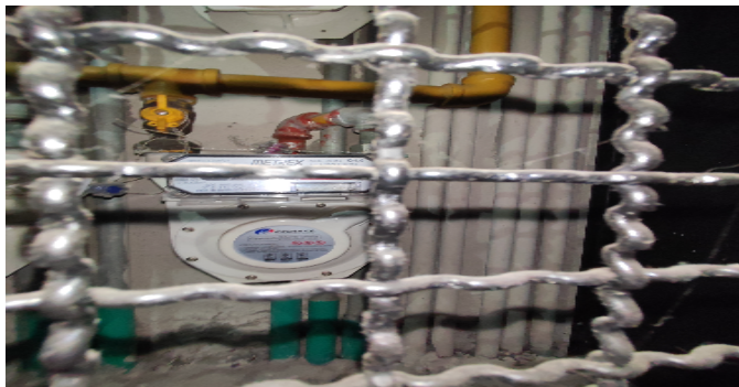
Contador de Gas
