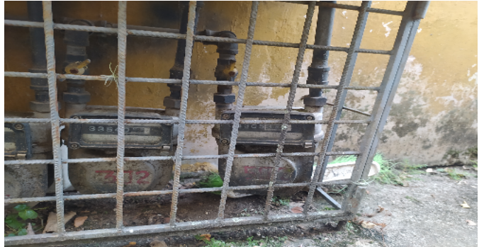
Contador de Gas
