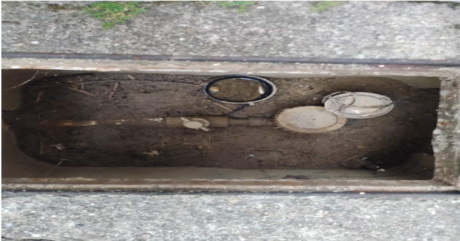
Contador de Agua
