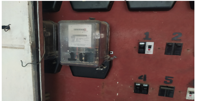
Contador de Energia
