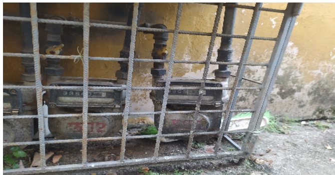
Contador de Gas
