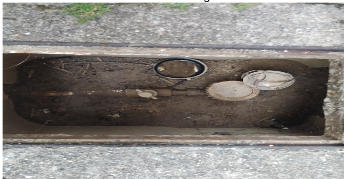
Contador de Agua
