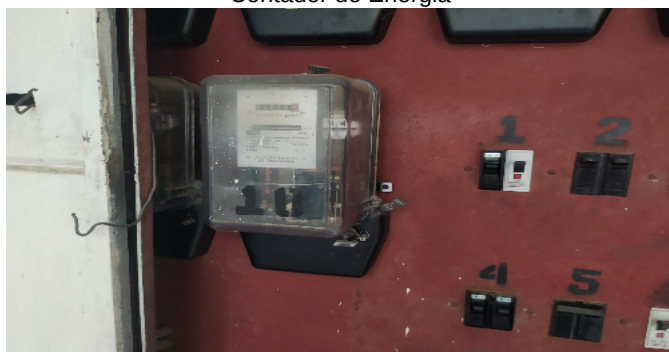
Contador de Energia
