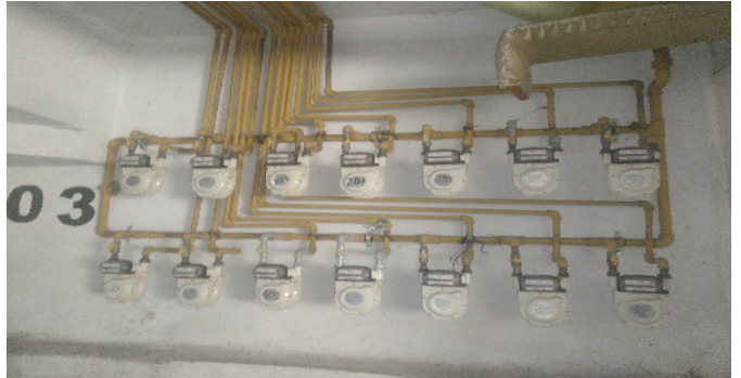
Contador de Gas
