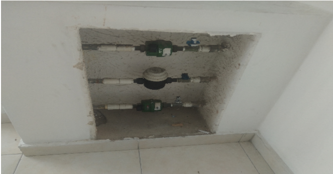
Contador de Agua
