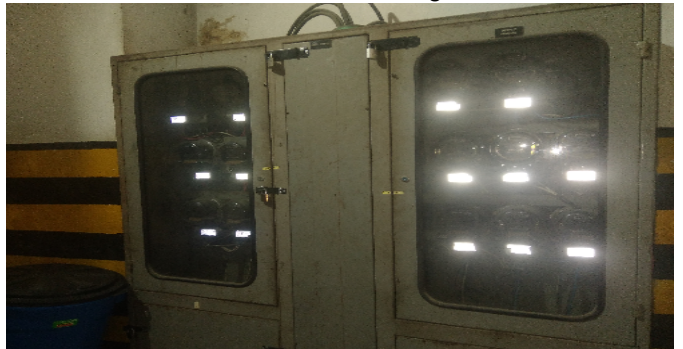
Contador de Energia
