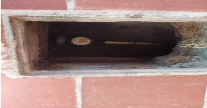
Contador de Agua
