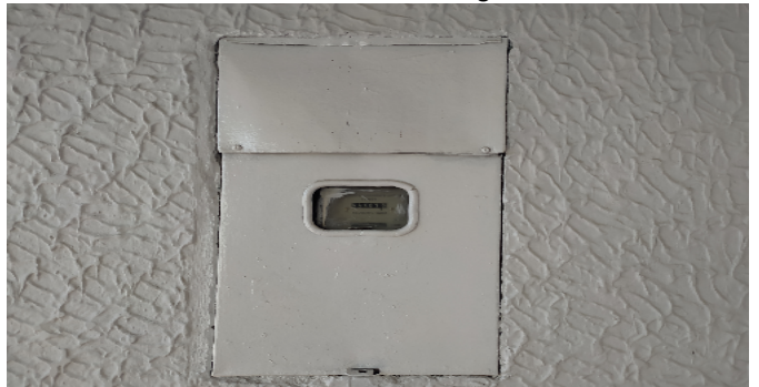
Contador de Energia
