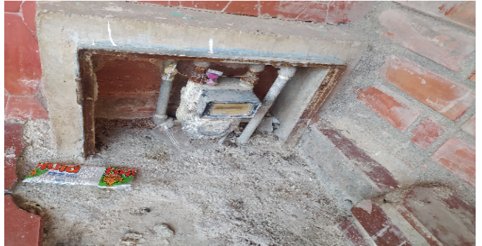
Contador de Gas
