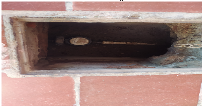
Contador de Agua
