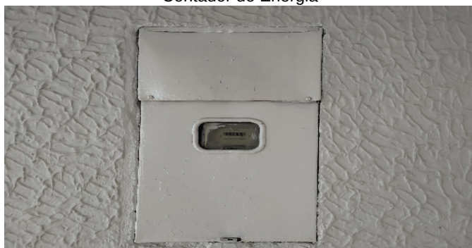
Contador de Energia
