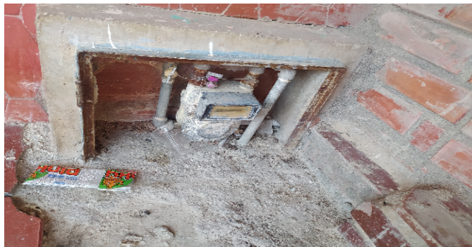
Contador de Gas
