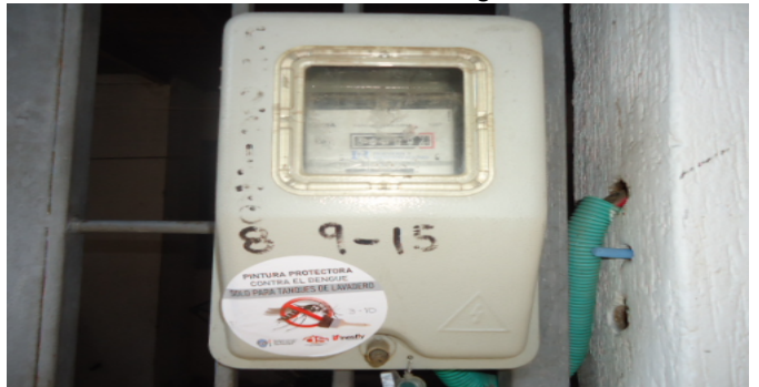
Contador de Energia
