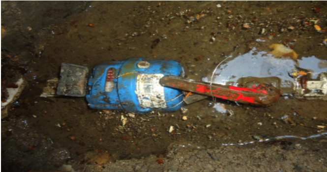
Contador de Agua
