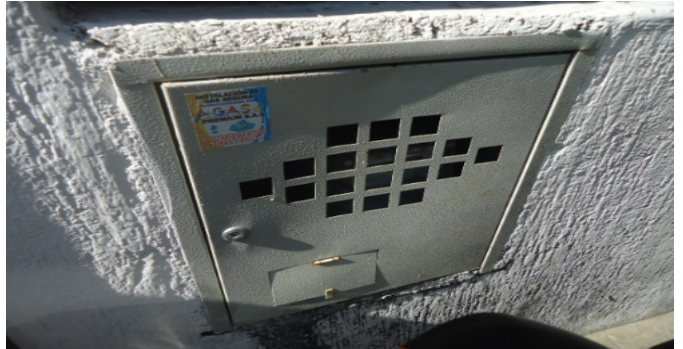
Contador de Gas
