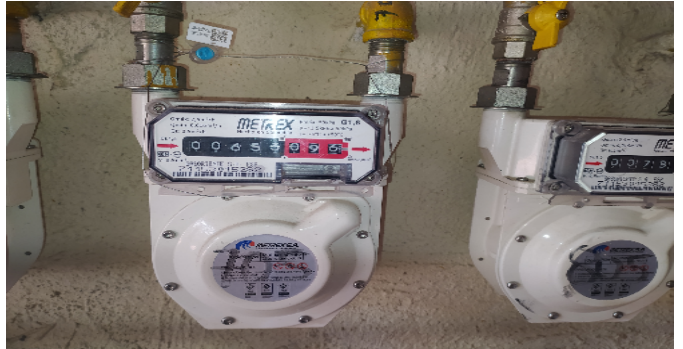
Contador de Gas
