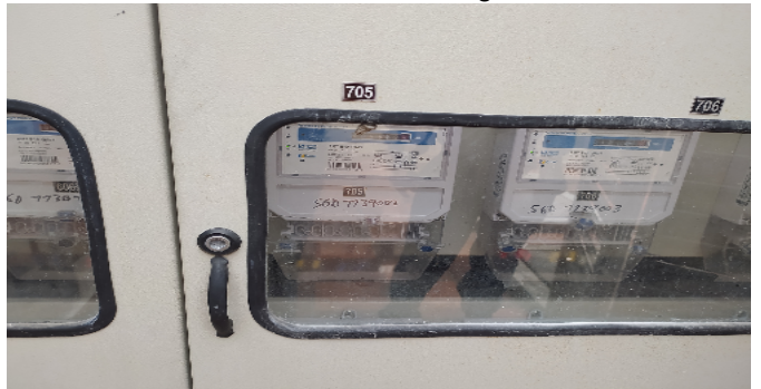
Contador de Energia
