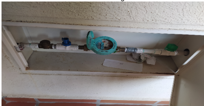
Contador de Agua
