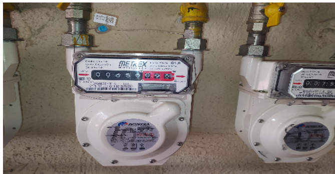
Contador de Gas
