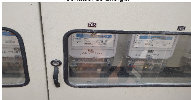
Contador de Energia
