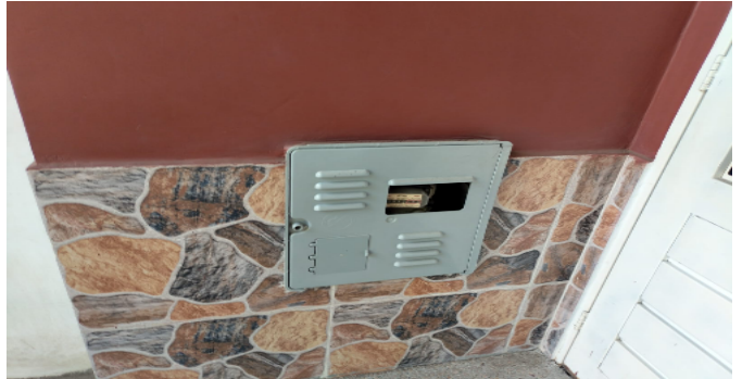
Contador de Gas
