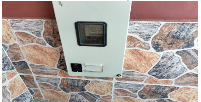
Contador de Energia
