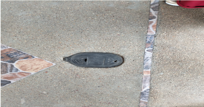
Contador de Agua
