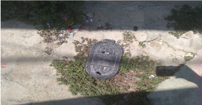
Contador de Agua
