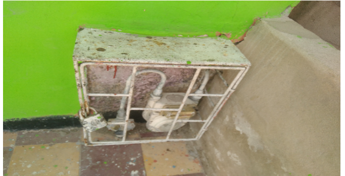
Contador de Gas
