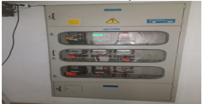
Contador de Energia
