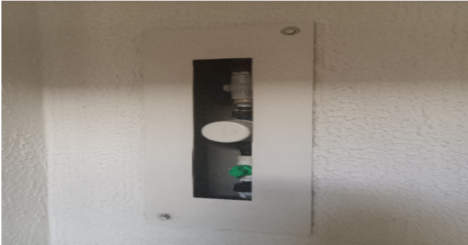
Contador de Agua
