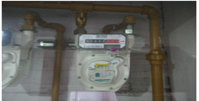
Contador de Gas
