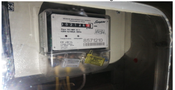
Contador de Energia
