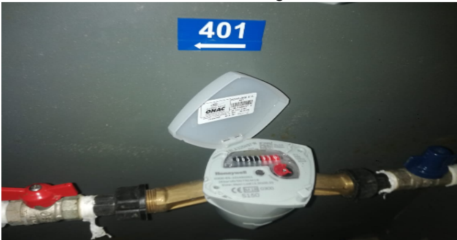
Contador de Agua
