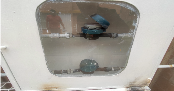
Contador de Agua
