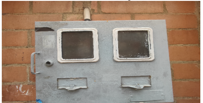
Contador de Energia
