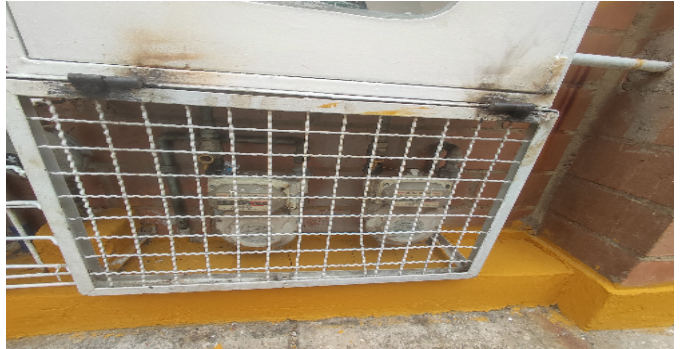
Contador de Gas
