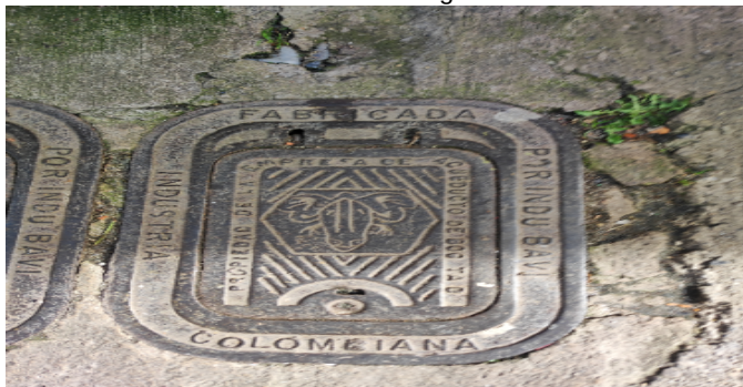
Contador de Agua
