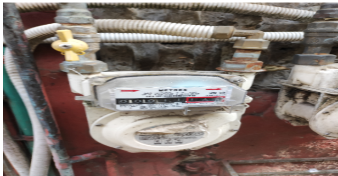
Contador de Gas
