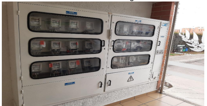
Contador de Energia
