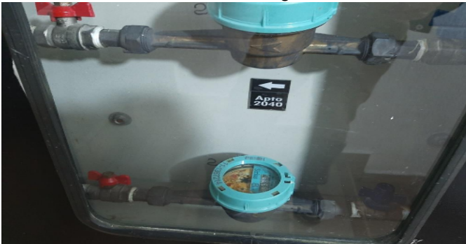
Contador de Agua
