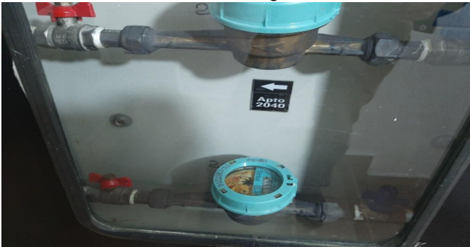
Contador de Agua-27
