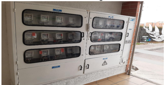
Contador de Energia-26
