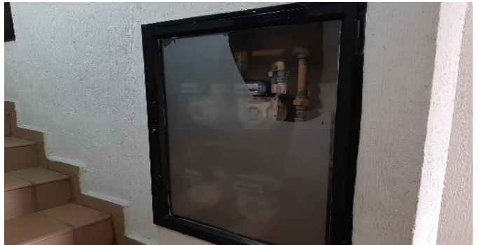
Contador de Gas-28
