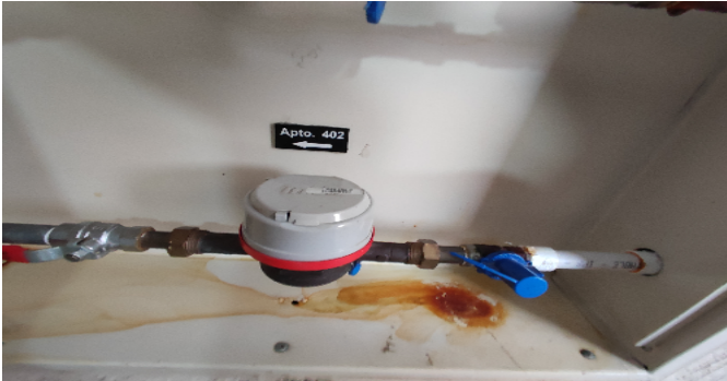
Contador de Agua
