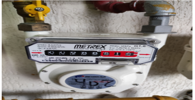
Contador de Gas
