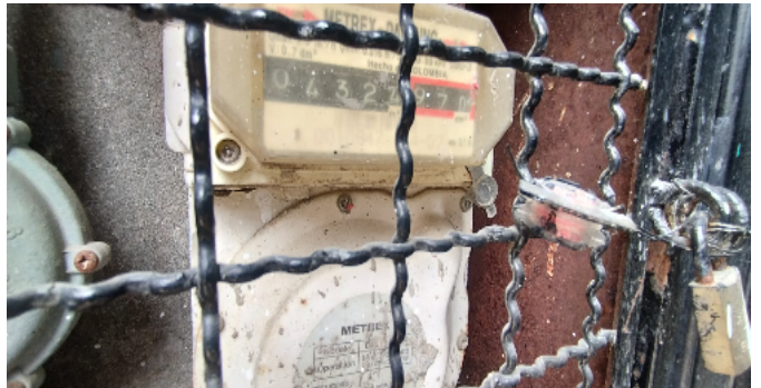
Contador de Gas
