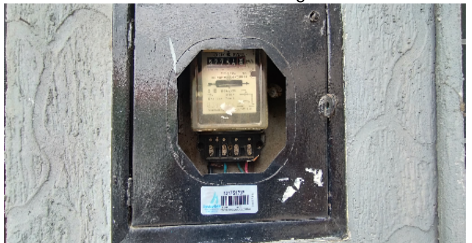
Contador de Energia
