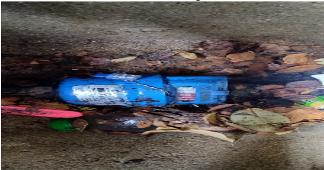
Contador de Agua
