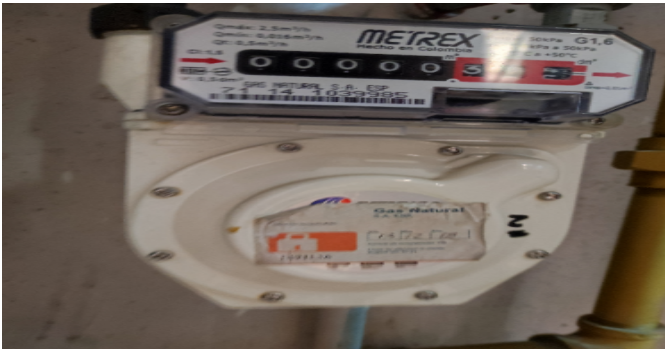
Contador de Gas
