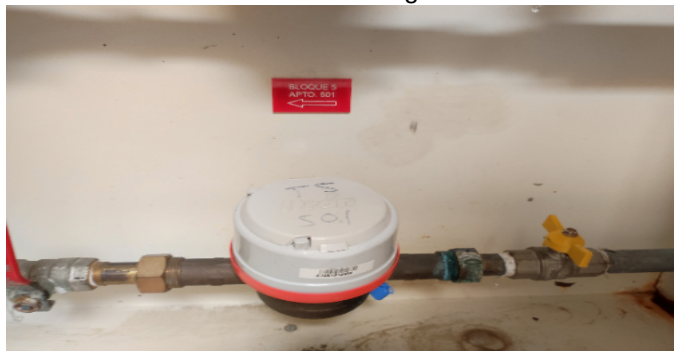
Contador de Agua
