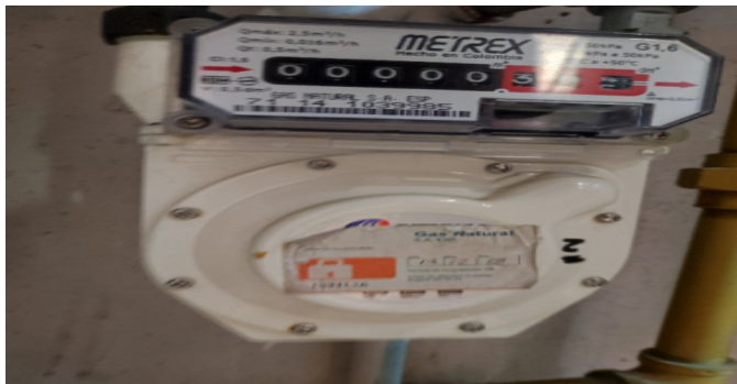
Contador de Gas
