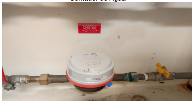
Contador de Agua
