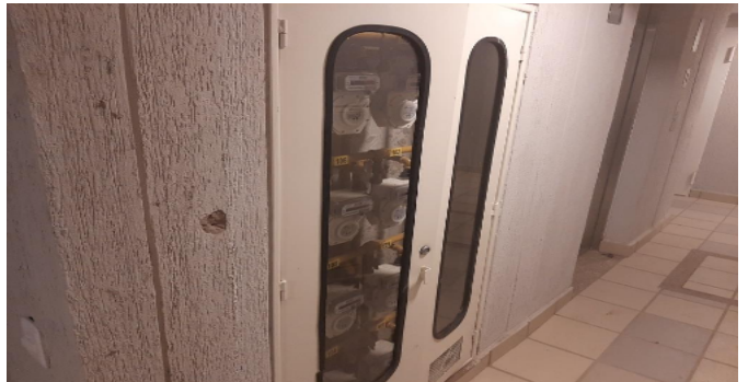
Contador de Gas
