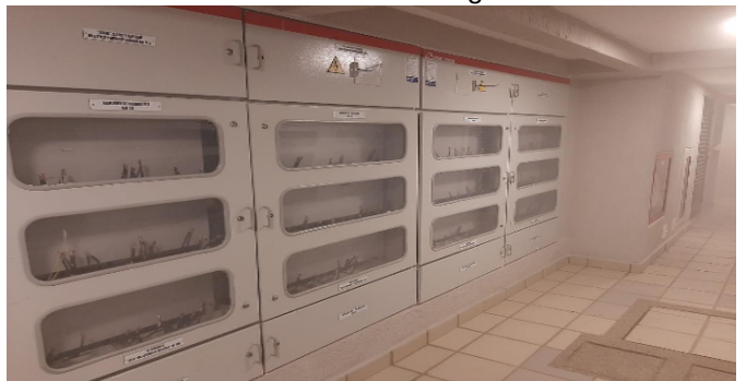
Contador de Energia
