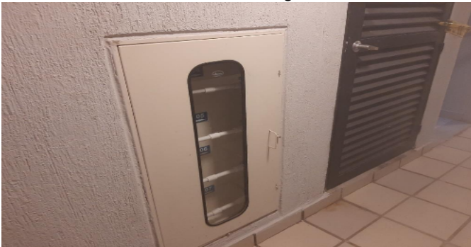
Contador de Agua
