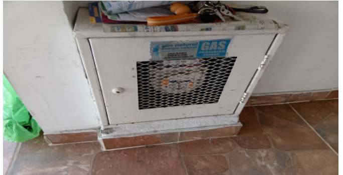
Contador de Gas
