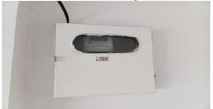
Contador de Energia
