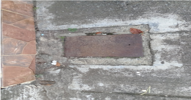
Contador de Agua
