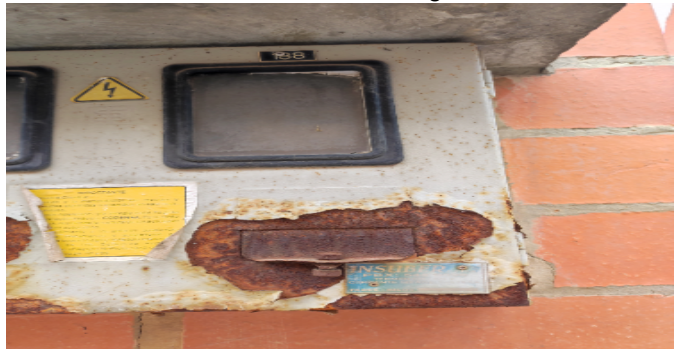
Contador de Energia
