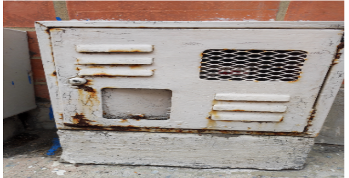
Contador de Gas
