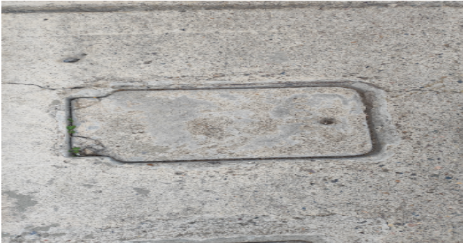
Contador de Agua
