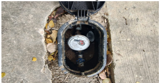
Contador de Agua
