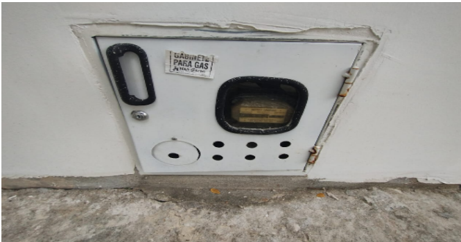
Contador de Gas
