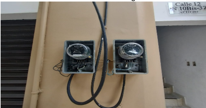
Contador de Energia
