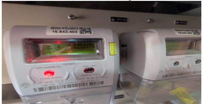
Contador de Energia
