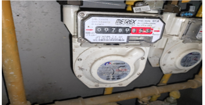
Contador de Gas
