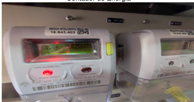
Contador de Energia
