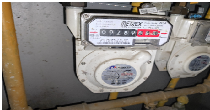
Contador de Gas
