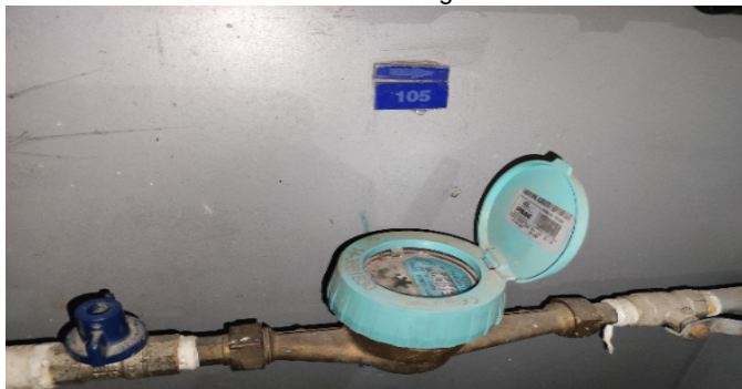
Contador de Agua
