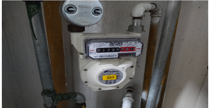
Contador de Gas
