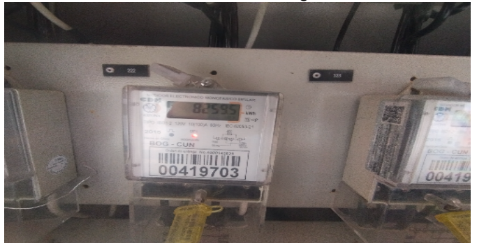
Contador de Energia
