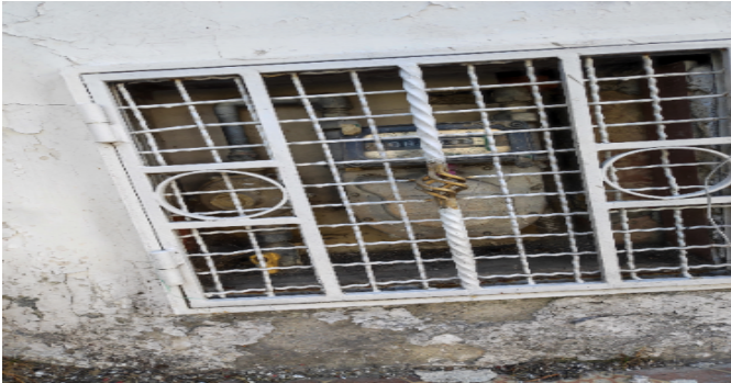
Contador de Gas
