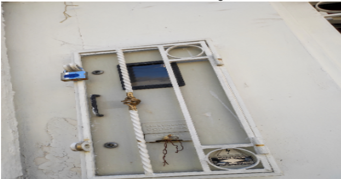
Contador de Energia
