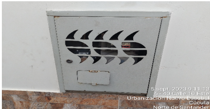
Contador de Gas
