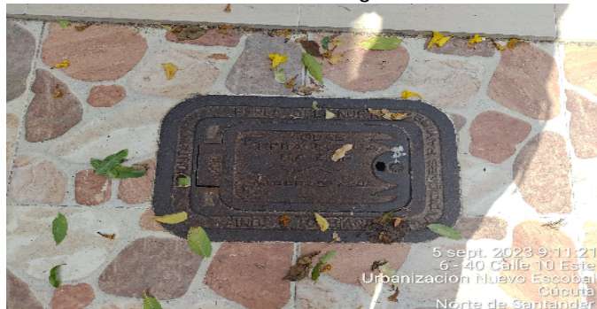
Contador de Agua
