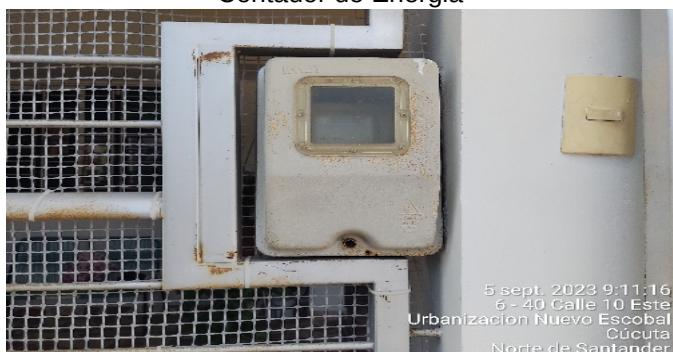
Contador de Energía
