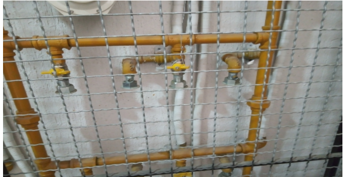
Contador de Gas
