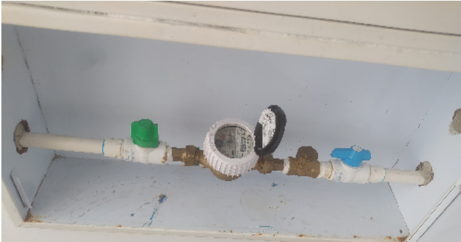
Contador de Agua
