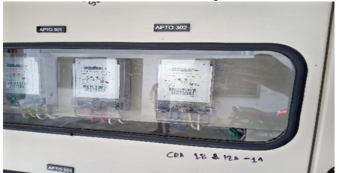
Contador de Energia
