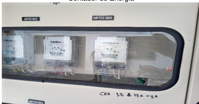
Contador de Energia
