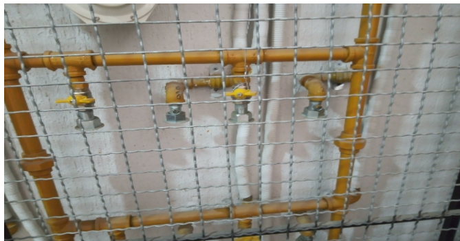
Contador de Gas
