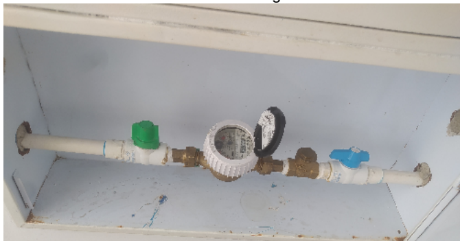
Contador de Agua
