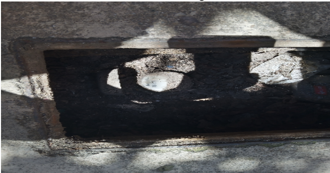
Contador de Agua
