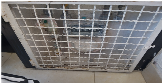
Contador de Gas
