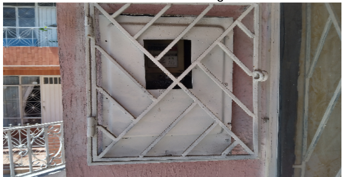
Contador de Energia
