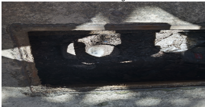
Contador de Agua
