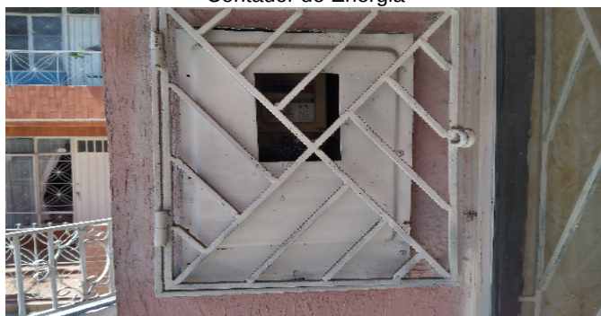
Contador de Energia
