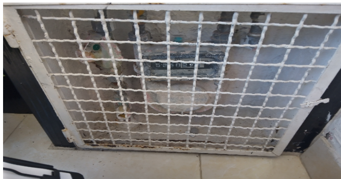
Contador de Gas
