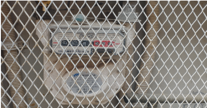
Contador de Gas
