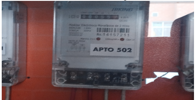
Contador de Energia
