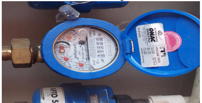
Contador de Agua
