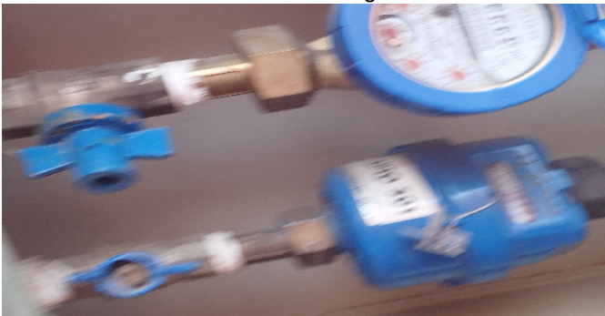
Contador de Agua
