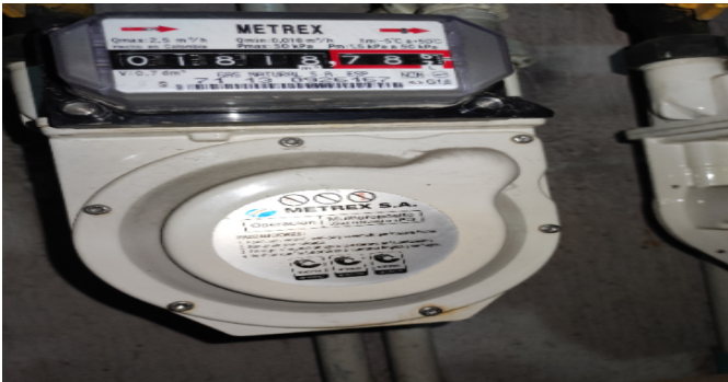
Contador de Gas
