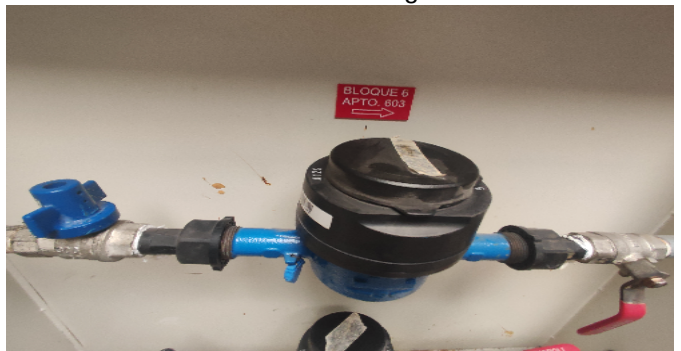
Contador de Agua
