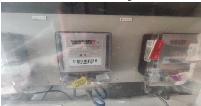
Contador de Energia
