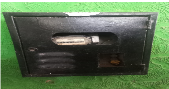
Contador de Gas
