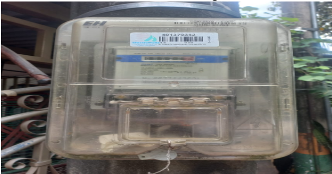
Contador de Energia
